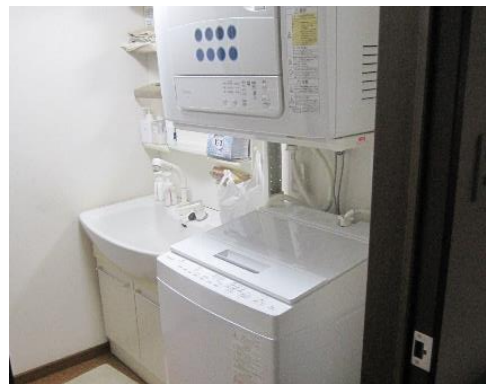
洗濯乾燥機の様子
